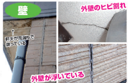
外壁のヒビ割れ
