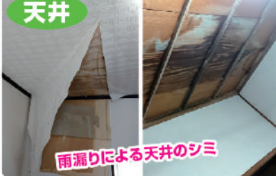
雨漏りによる天井のシミ
