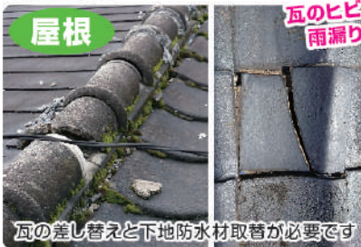
瓦の差し替えと下地防水材取替が必要です
