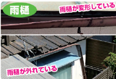
雨樋が変形している
