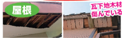
瓦下地木材腐んでいる
