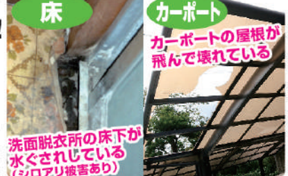
カーポートの屋根が飛んで壊れている
